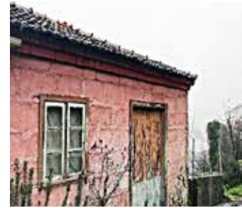
Figura 3 - Revestimento e paredes degradadas
