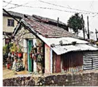
Figura 2 - Ampliação ilegal e precária de uma habitação
