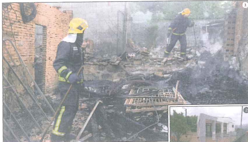
1 Equipas de socorro removeram os escombros resultantes do acidente 2 Escola Básica de Ganfei, em Valença, ficou afetada com a explosão de Tui
