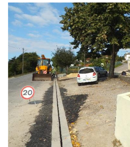
Colocação de canaletas e execução de valetas na reta de Fojos, em Outeiro
