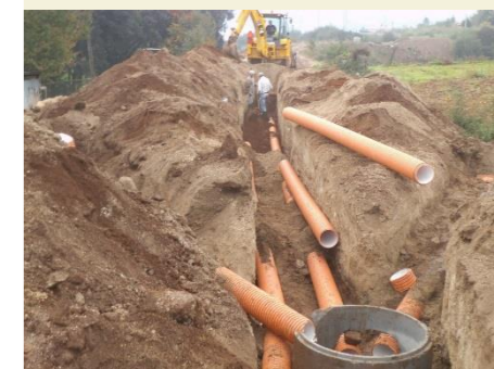
Construção de rede de esgotos e de águas pluviais, na estrada de ligação da Rotunda da Variante ao cemitério do Arco de Baúlhe
