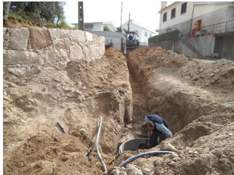
Execução de conduta de esgotos na Rua do Alto do Pinheiro, em Refojos
