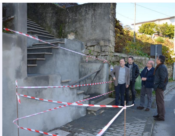
No final do ano a Câmara com a colaboração da junta de freguesia iniciou obras de reabilitação das escadas entre a Rua das Acácias e a Rua Dr. Agostinho Moutinho
