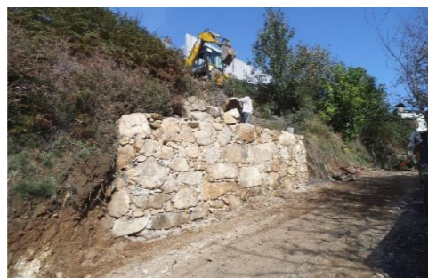
Construção de muro de suporte no Caminho de Morgade, Arco de Baúlhe
