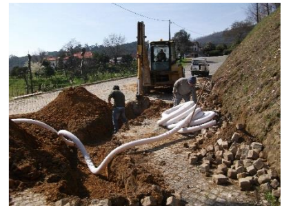
Colocação de dreno no Caminho de acesso à zona de lazer de Vila Nune.
