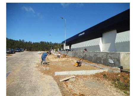
Pavimentação de passeios e zonas de estacionamento - Parque Industrial de Vila Nune
