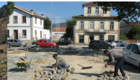
instalação de infraestruturas de saneamento e reposição de pavimento no Largo do Campo do Seco
